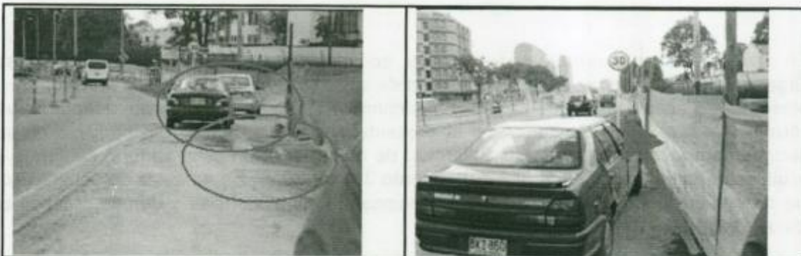
No se está garantizando la continuidad del flujo peatonal, sendero sin protección y delimitación por lo tanto se mezcla con el flujo vehicular del sector con el tránsito de los peatones; falta de señalización.
