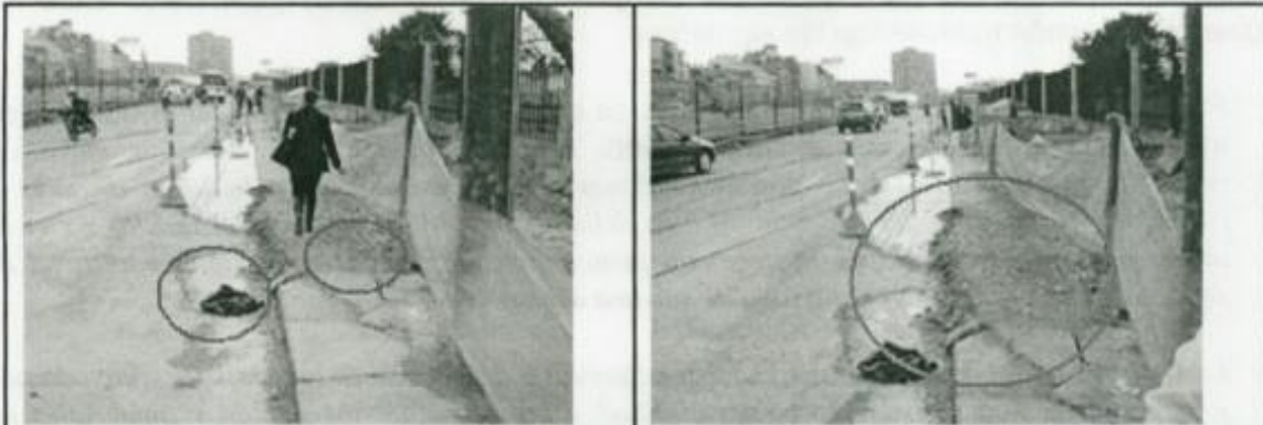
Los senderos peatonales se encuentran delimitados en esta zona, pero se encuentran en malas condiciones con las cuales no se aísla el peatón de la obra, ya que se transita sobre escombros e igualmente estancamientos de agua.
