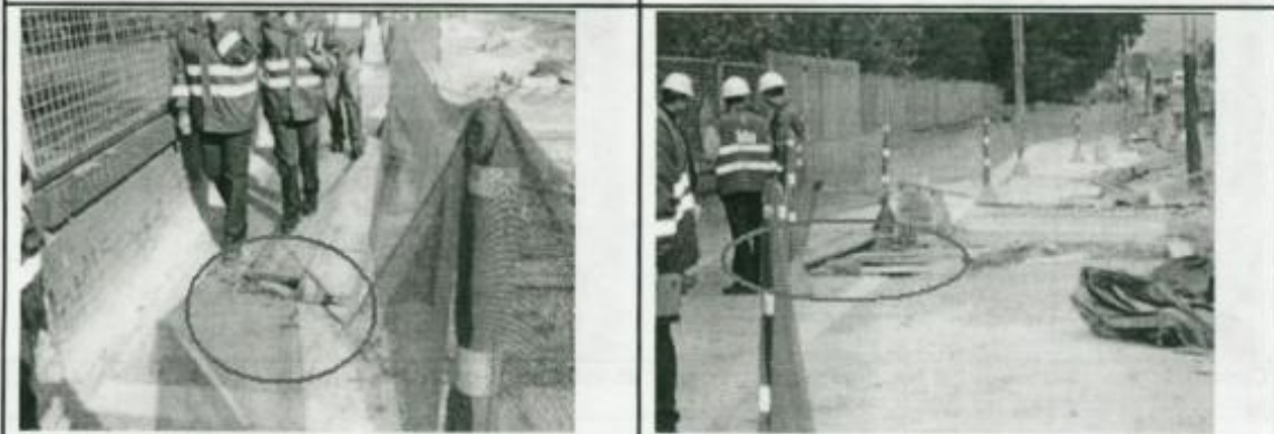
Senderos inestables, estrechos y sin protección en la zona de Excavación de la obra que atentan contra la seguridad del peatón creando sobresaltos en la continuidad del mismo.
